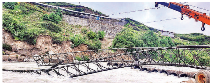
चमोली। चमोली जिले में बदीनाथ धाम में मास्टर प्लान के तहत अलकनंदा नदी पर निर्माणाधीन पुल का एक हिस्सा बुधवार को निर्माण कार्य के दौरान ढह गया।
